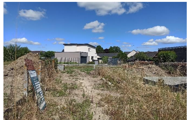
Logement individuel en cours de construction au sein de l'enveloppe urbaine à Saint-Augustin-des-Bois en juin 2022. Crédit photographique : MERC/AT
